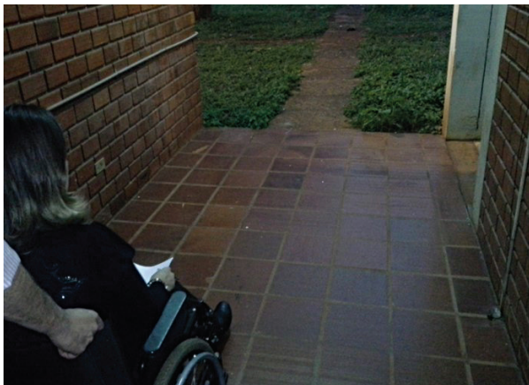
Figura 11 – Passarela com dimensões inadequadas
