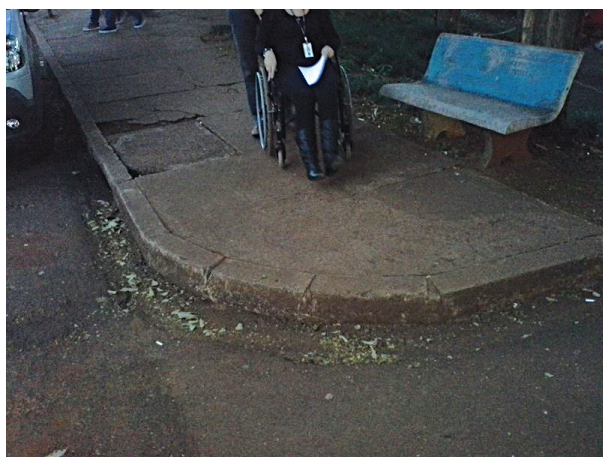
Figura 7 – Falta de rampas de acesso
